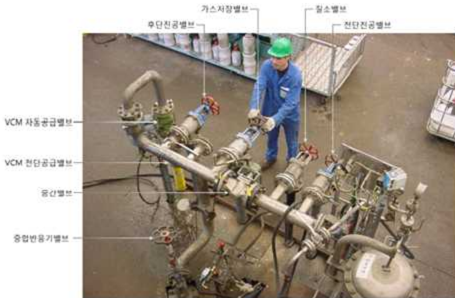
그림2. 사고가 발생한 배관의 밸브 위치
